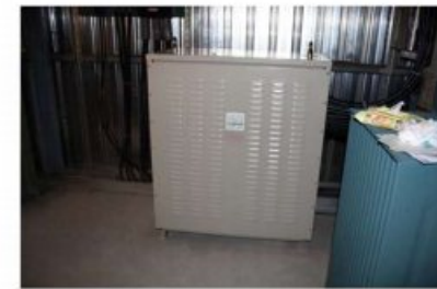
苗栗縣農*企業印刷材料廠 安裝低壓 SF-1000KVA 節電器 驗收節電率： 13.21%
