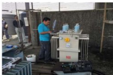
新北市友*企業電子廠 安裝高壓 SFH-800KVA 節電器 驗收節電率： 13.75%
