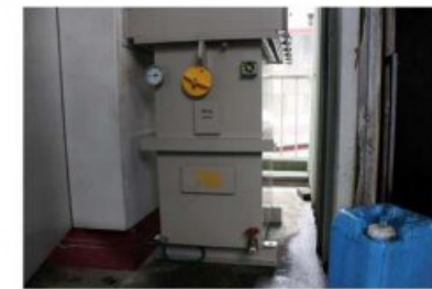
新北市昕*企業電路板酸洗廠 安裝高壓 SFH-700KVA 節電器 驗收節電率： 13.4%
