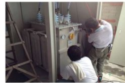
桃園市上*工業電子廠 安裝高壓 SFH-1000KVA 節電器 驗收節電率： 12.53%
