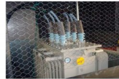
高雄市海*王冷凍一、二廠 安裝高壓 SFH-2000KVA 節電器 驗收節電率： 23.08%
