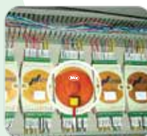
通信環控室異常溫度偵測
