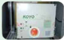
大型UPS異常溫度偵測
