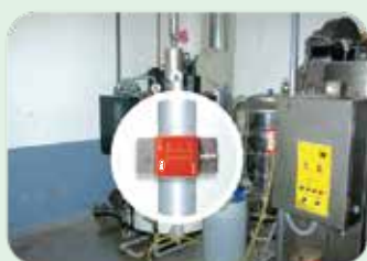
蒸氣管異常溫度偵測
