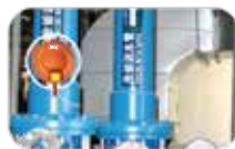
冰水機管路異常溫度偵測
