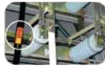
高壓大電纜異常溫度偵測
