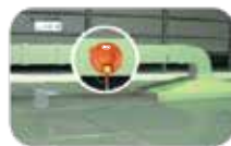
空調風管異常溫度偵測
