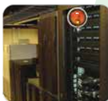
雲端通信機房機架前後溫度異常偵測
