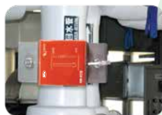
空調冰水回水管異常溫度偵測
