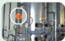
蒸氣管異常溫度偵測
