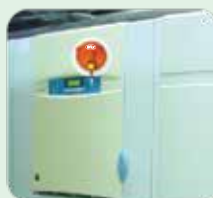
UPS房溫度濕度偵測 電容溫度安全偵測
