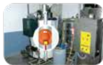
鍋爐異常溫度偵測
