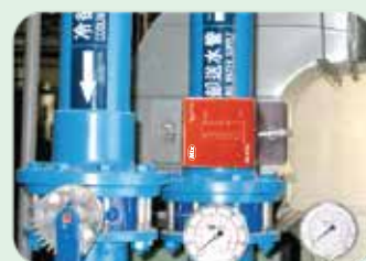
空調冷水機冷卻水異常溫度偵測
