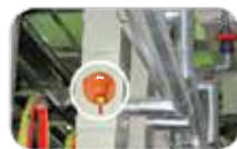
排廢氣管異常溫度偵測
